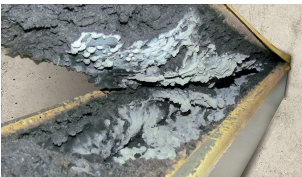
Aufgeschäumter Dämmschichtbildner im Inneren des Kabelkanals verhindert Brandausbreitung
